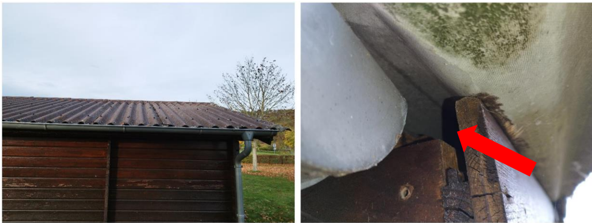
Abb. 2-2: Links: Blick auf das Welldach des Vereinsheims. Rechts: Auflage vom Welldach auf dem Holzaufbau der Hütte. Hinter der Regenrinne gibt es Einflugmöglichkeiten (Roter Pfeil).
